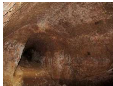
Nave bodega acceso tapado
