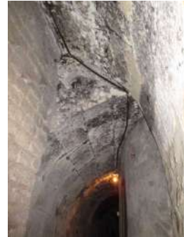
Bóvedas de cañón desplazadas
